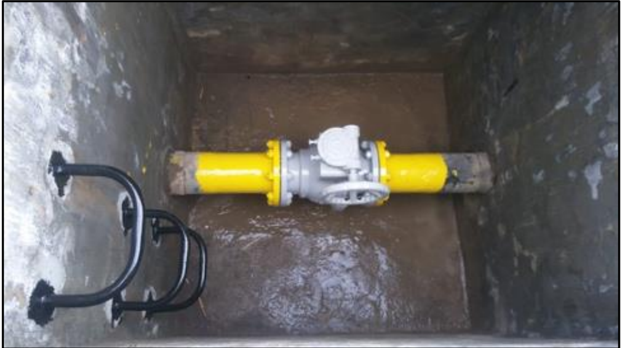
10.53 CXE0017 (BR-101, na travessia do ramal Vidreira do Nordeste, sentido Aracaju-Estância).
