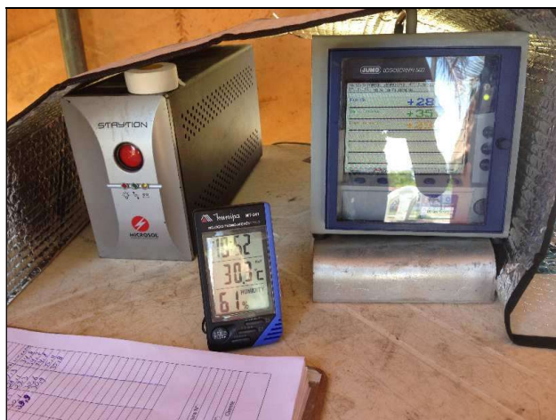
Figura 36 – Aparelhos registradores de pressão e temperatura
