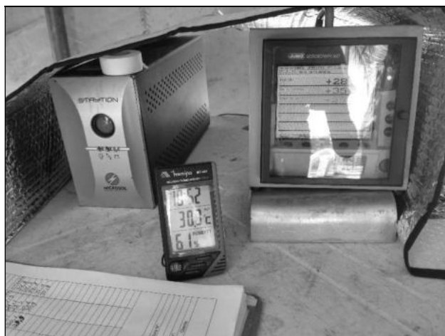
Figura 36 – Aparelhos registradores de pressão e temperatura
